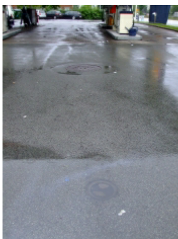
Boring med ødelagt betonkegle står under vand med oliefilm
